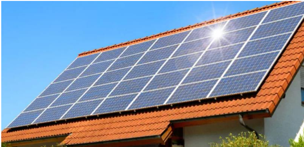
Figuur 7: Foto van zonnepanelen op een dak [14]
